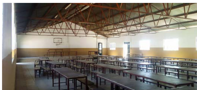
Egalement les murs intérieurs ont eu droit à une nouvelle couche de plâtre et de couleur.
